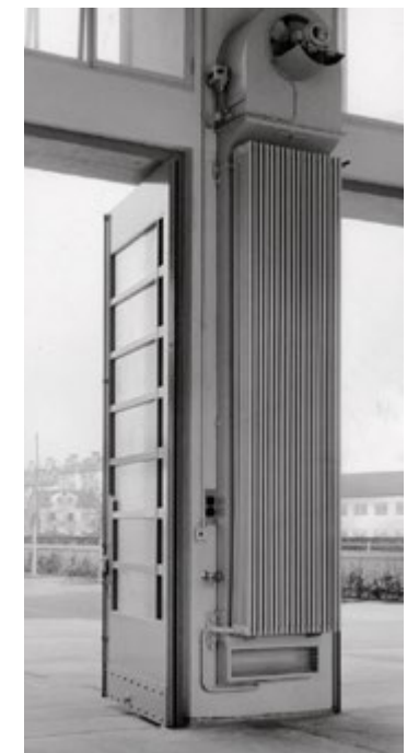
Durch seine Anpassungsfähigkeit eignet sich der Zehnder-Radiator für Spezialanwendungen (Beispiel aus den 50er-Jahren: Brandwache Zürich).
